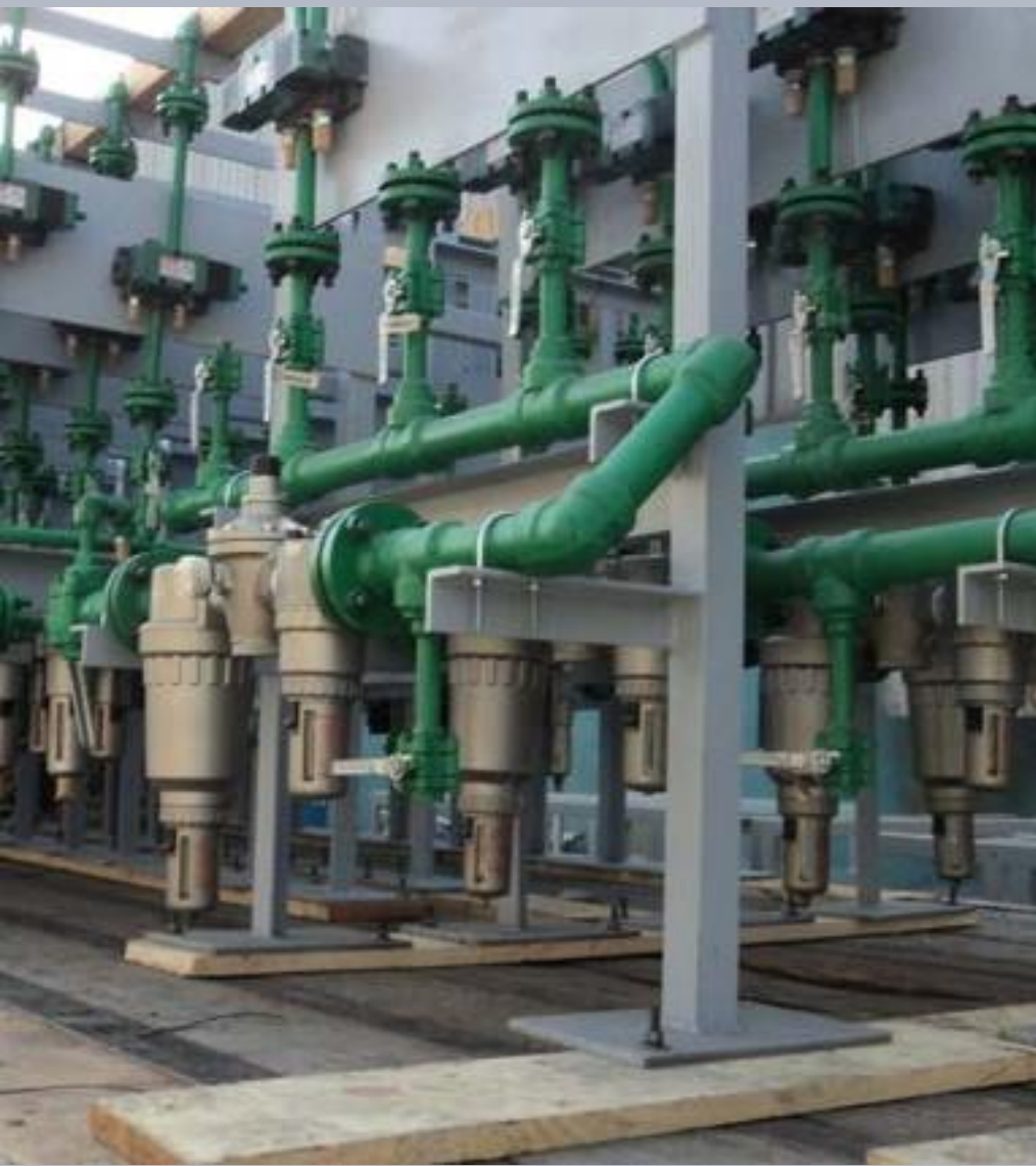
BANCO DE VALVULAS NEUMATICO
